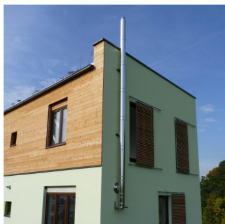
Fasádní nerezový komín na novostavbě
