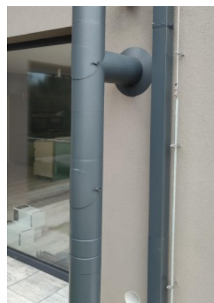
Lakovaný komín s kulatým čistícím otvorem
