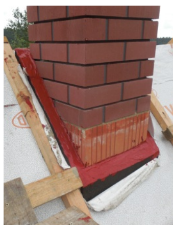
Parotěsný vstup cihelného komína
