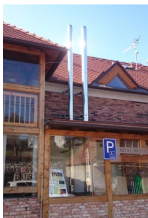
Novostavba s nerezovými komíny
