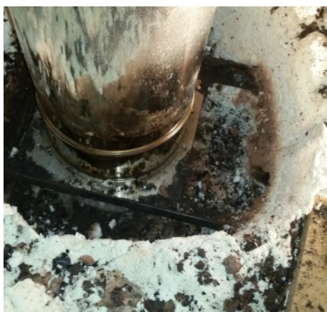
Následek chybně zaizolovaného prostupu komínu stropem
